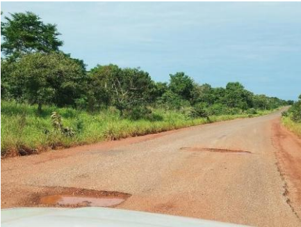
Photos 27:PK153-nid de poule profond et stagnation
