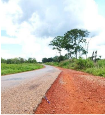
Photos 5: PK15-Forte dénivelée entre la chaussée et l'accotement (supérieur à 10 cm)
