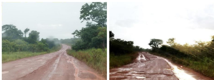
Photos 16: PK53 et PK60, ravinements longitudinaux
