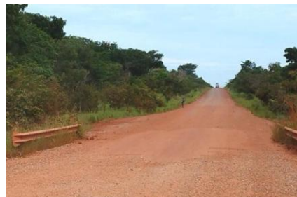
Photos 19: PK192-arrachement sur une dizaine de mètres
