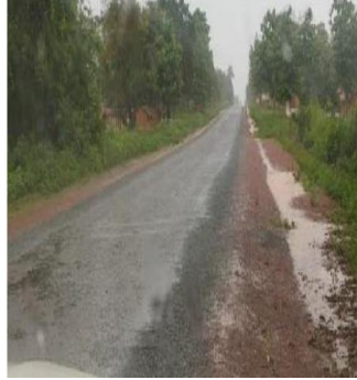
Photos 44: Fossé trapézoïdal en terre
