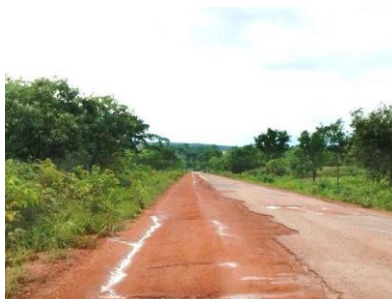
Photos 21: PK134-épaufure de côté gauche de la chaussée
