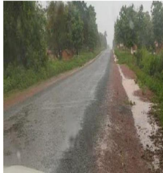
Photos 44: Fossé trapézoïdal en terre
