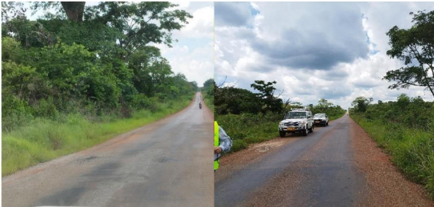
Photos 6:PK8.4-ressuage généralisé sur la chaussée
