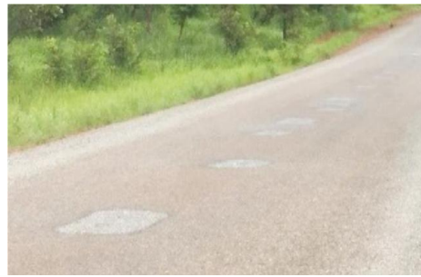
Photos 4: PK39-nids de poules rebouchés
