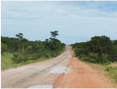
Photos 29 : PK211-dénivellation de l'accotement
