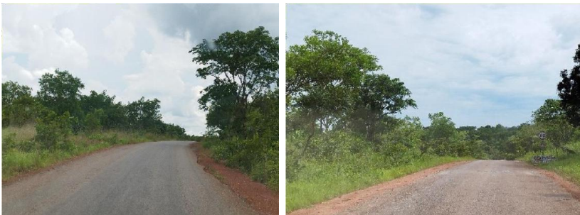
Photos 36: PK17+200 et PK208: points hauts et absence de visibilité à corriger
