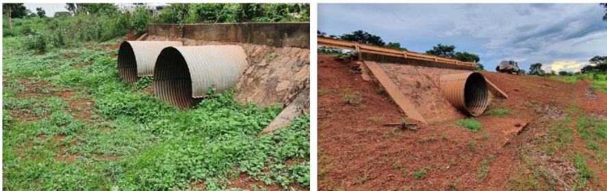
Photos 39: 2Buses métalliques de diamètre 2000 (PK
