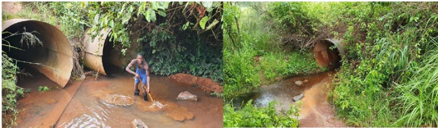
Photos 37: 2 Buse métallique de diamètre 2000
