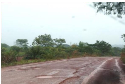
Photos 9:PK53-dentelle de rive du côté droit de la
